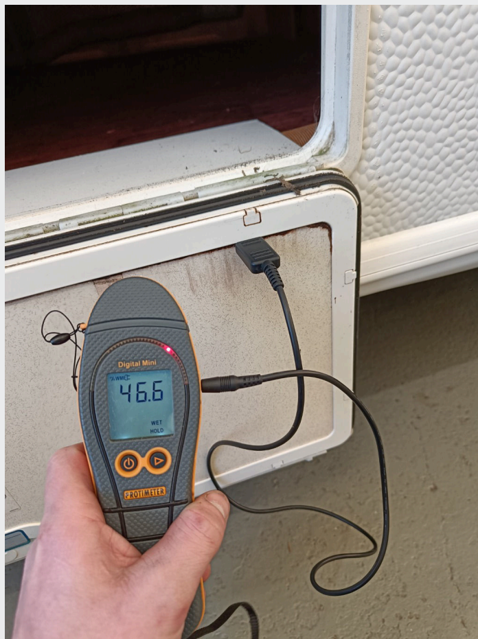
1.6 46,6% i lasteluke under dobbeltseng. Innmat må skiftes.
