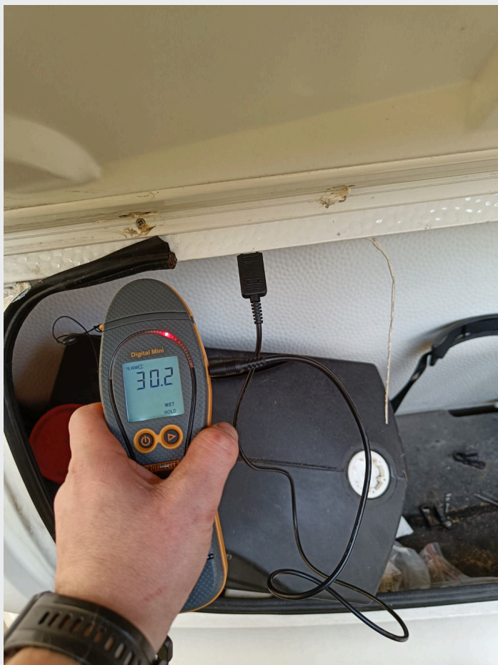
2.11 Fukt i høyre hjørnet fremme. 30,2%
