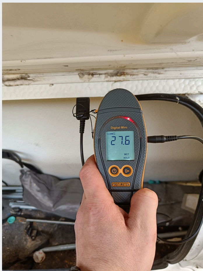
2.11 Fukt venstre side fremme. 27,6%
